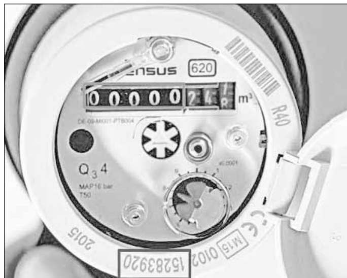
Beispiel Zählernummer 15283980 Zählerstand 0
