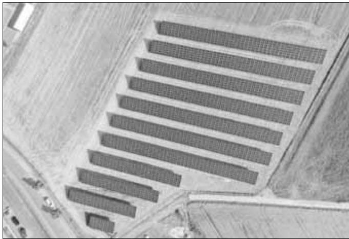
Die 750 kWp-PV-Anlage wurde im Jahr 2020 als 1. Bauabschnitt im Interkommunalen Gewerbegebiet Salzbödetal errichtet.
